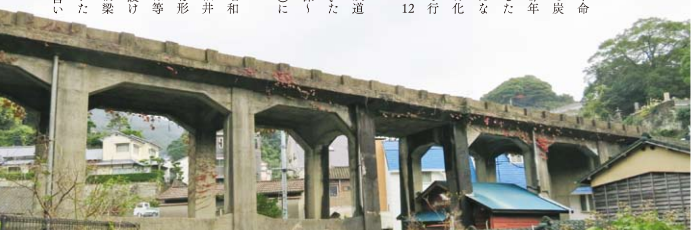
花園町橋梁 昭和初期、佐世保は急激に市街化したため、市内の鉄道の多くが高架線となった
